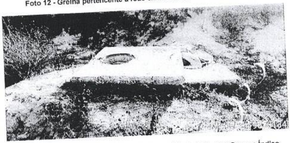
Foto 13 - Poço de visita pertencente à rede existente "a" - Av. Oceano Índico
